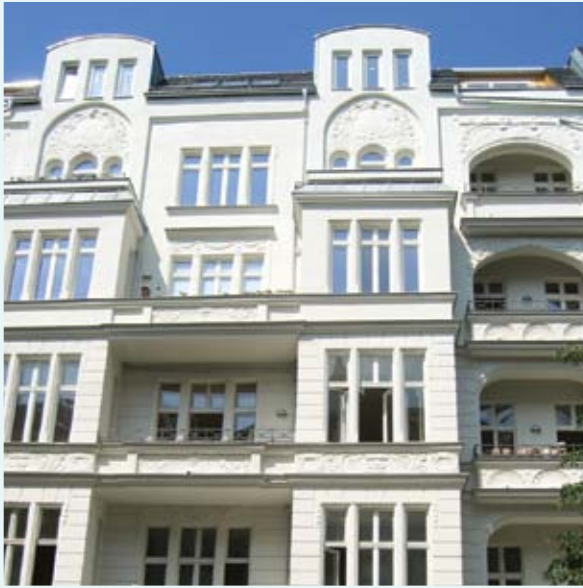
Simon Dach Straße 7: Sanierte Fassade 2011; Unsanierte Fassade
